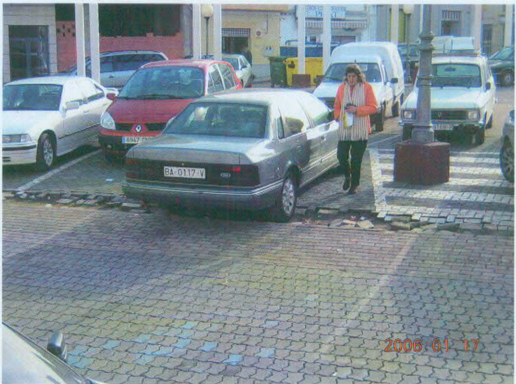
Precario estado del pavimento en acceso desde la Explanada
