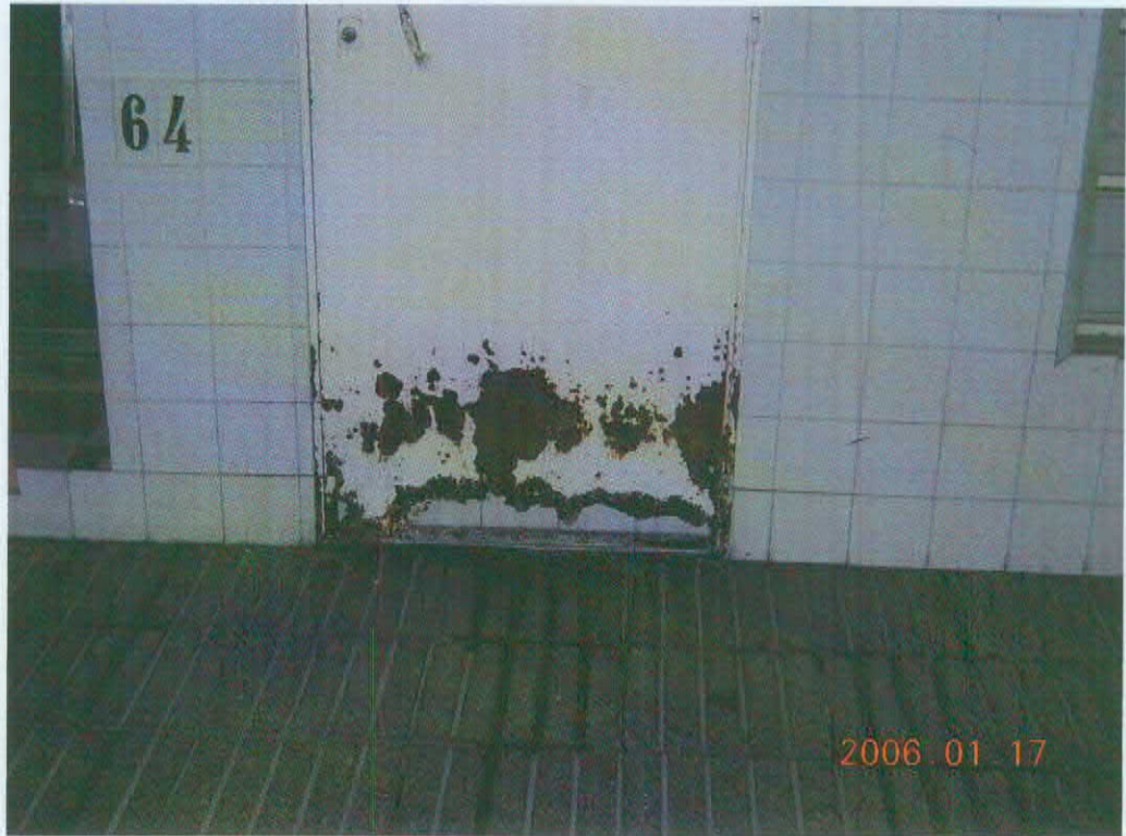
Corrosión de elementos metálicos
