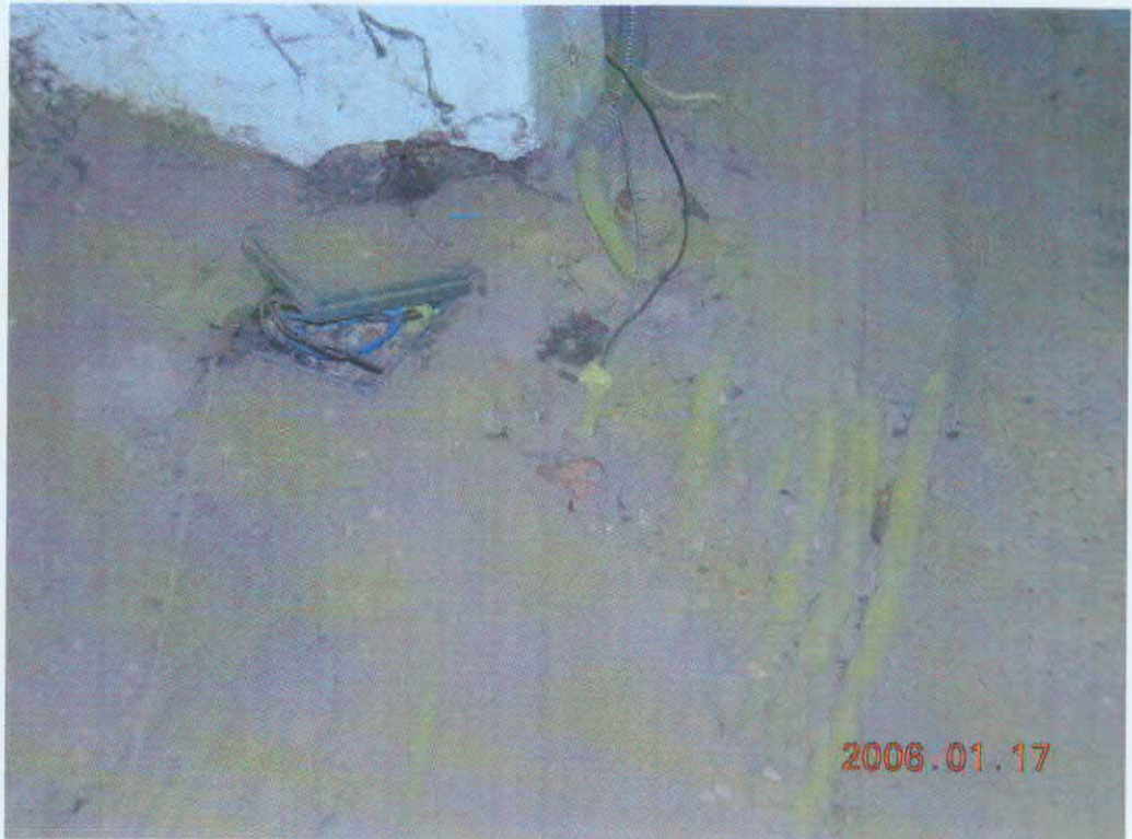
Instalaciones particulares en mal estado
