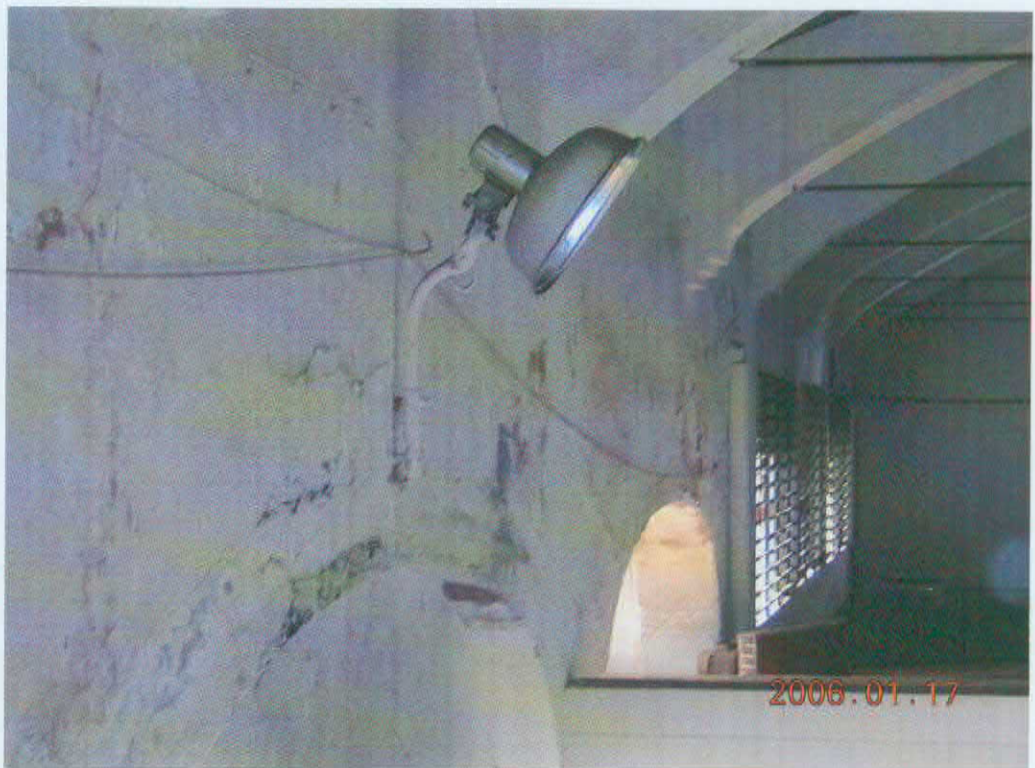
Desconchones en cerramientos. Luminaria inadecuada
