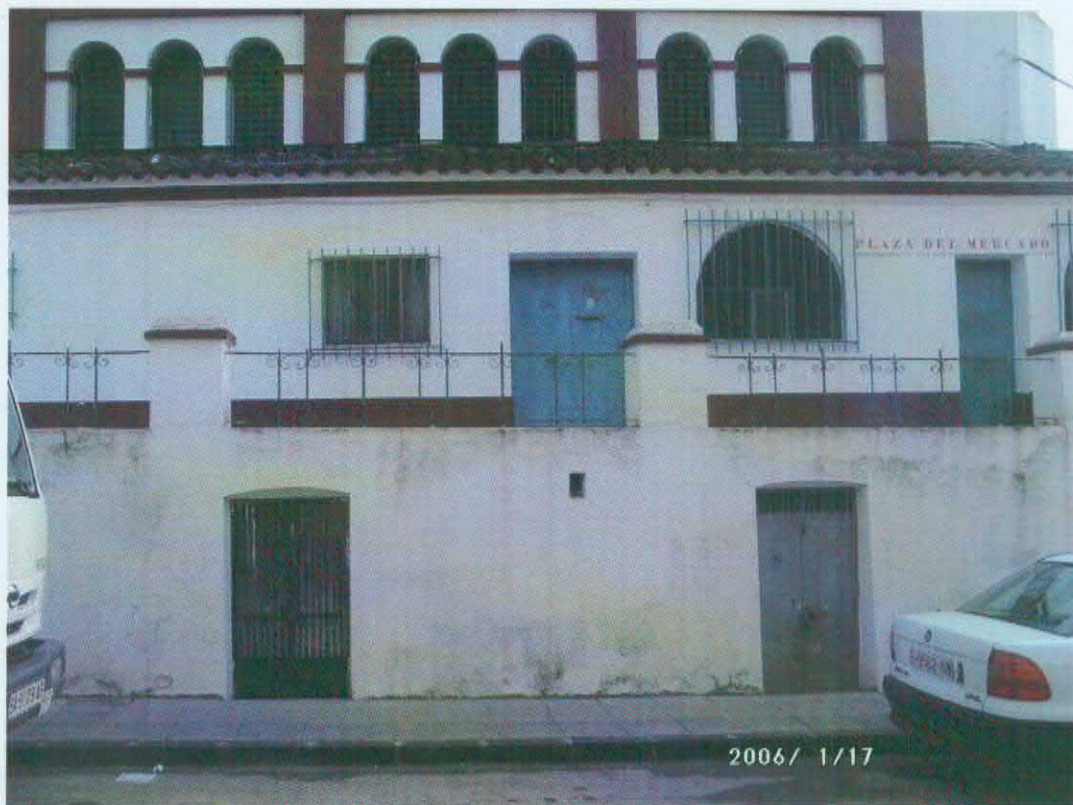
Almacenes exteriores en estado de ruina
