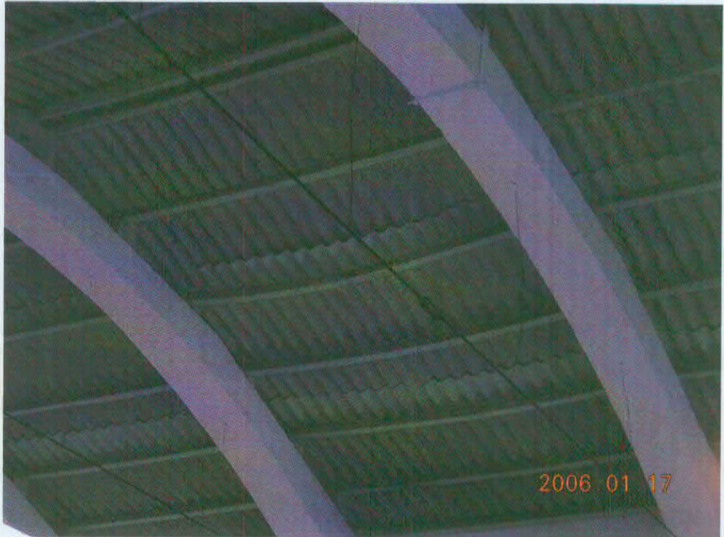
Importantes deformaciones de correas en cubierta
