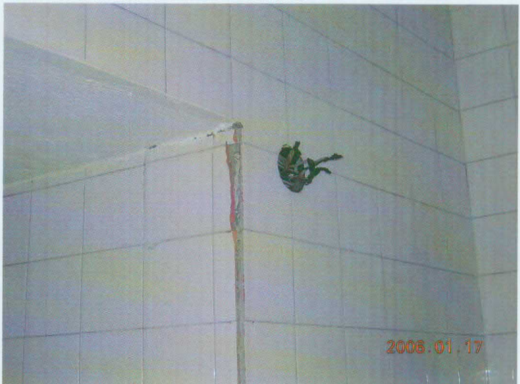
Instalación eléctrica precaria
