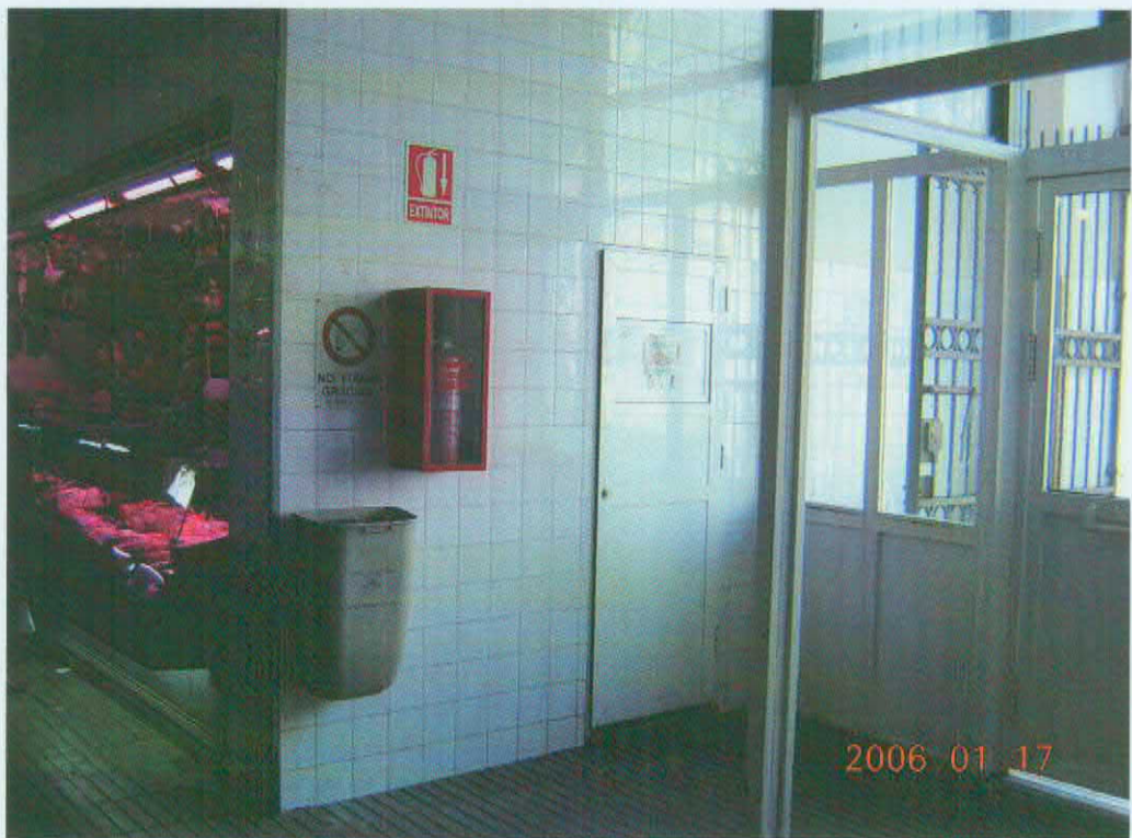
Instalación contra incendios insuficiente
