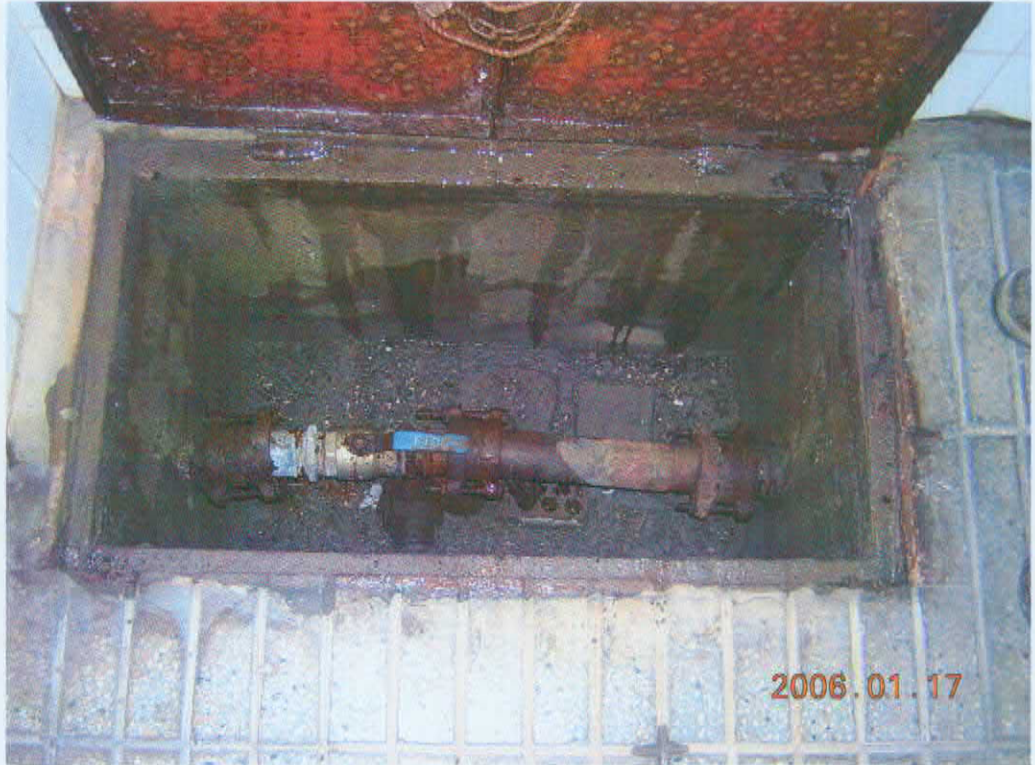
Necesaria renovación de red de agua.
