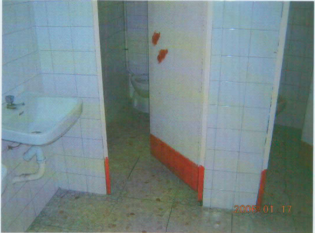
Aseos en malas condiciones
