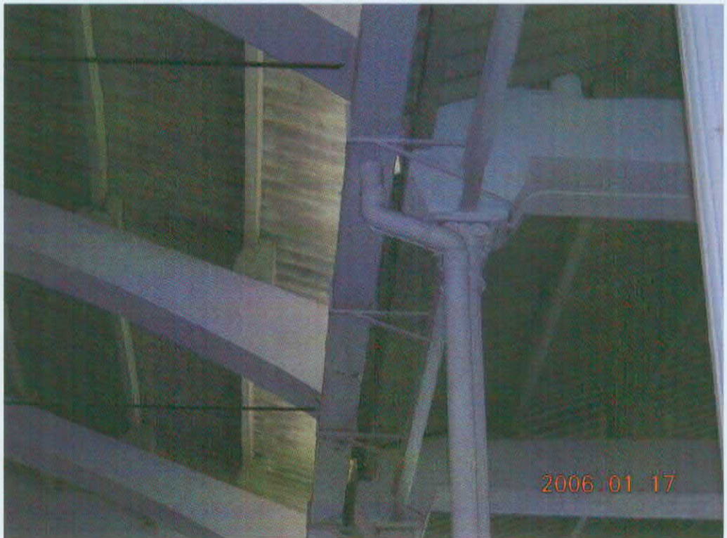
Imposibilidad física de mantenimiento de canalones por el mal estado de la cubierta.
