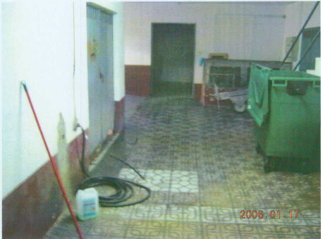
Zona de residuos con acabados inapropiados
