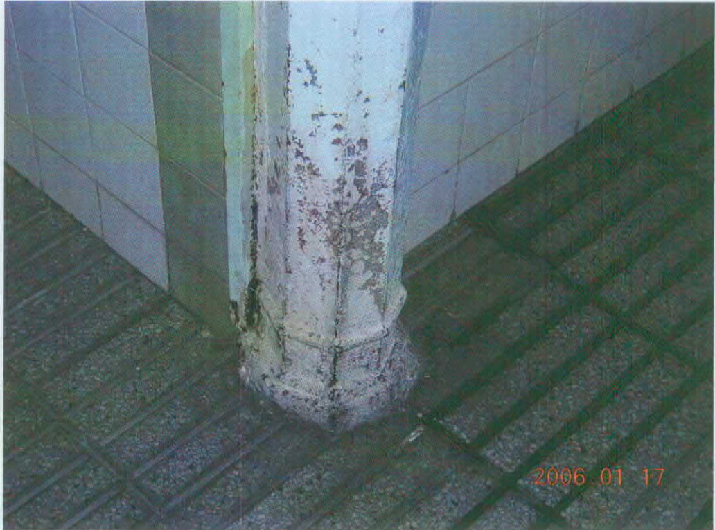
Necesidad de tratamiento anticorrosivo
